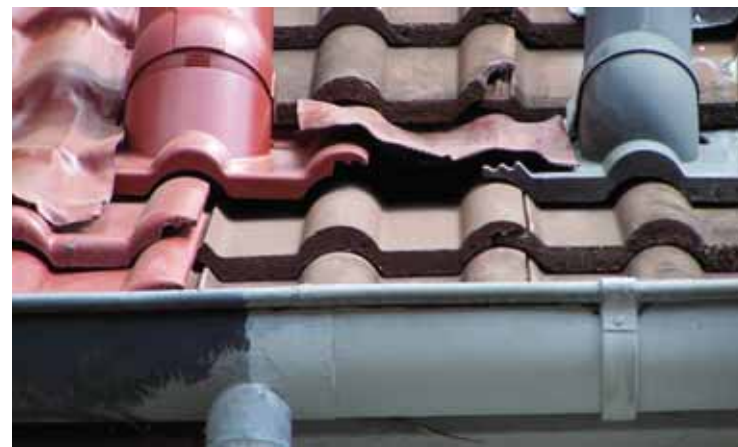
Dachschaden: Ob Wetter oder Pfusch, vor dem Winter sollte das Haus in Augenschein genommen werden. Foto: Verband Privater Bauherren e.V.
