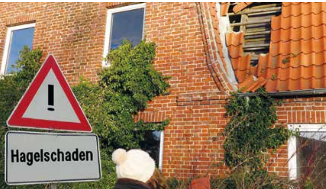
Unwetter können erhebliche Schäden an Wohnhäusern anrichten. Eine stabile und wetterfeste Dachdämmung leistet einen wichtigen Beitrag zum Schutz des Gebäudes. Foto: DJD/puren/pusteflower9024-stock.adobe.com
